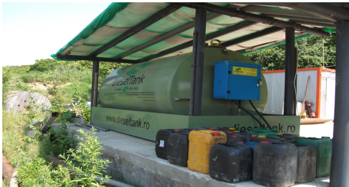
Figura 2.1.1 - Depozit de carburanți în zona organizării de șantier, PC 01
