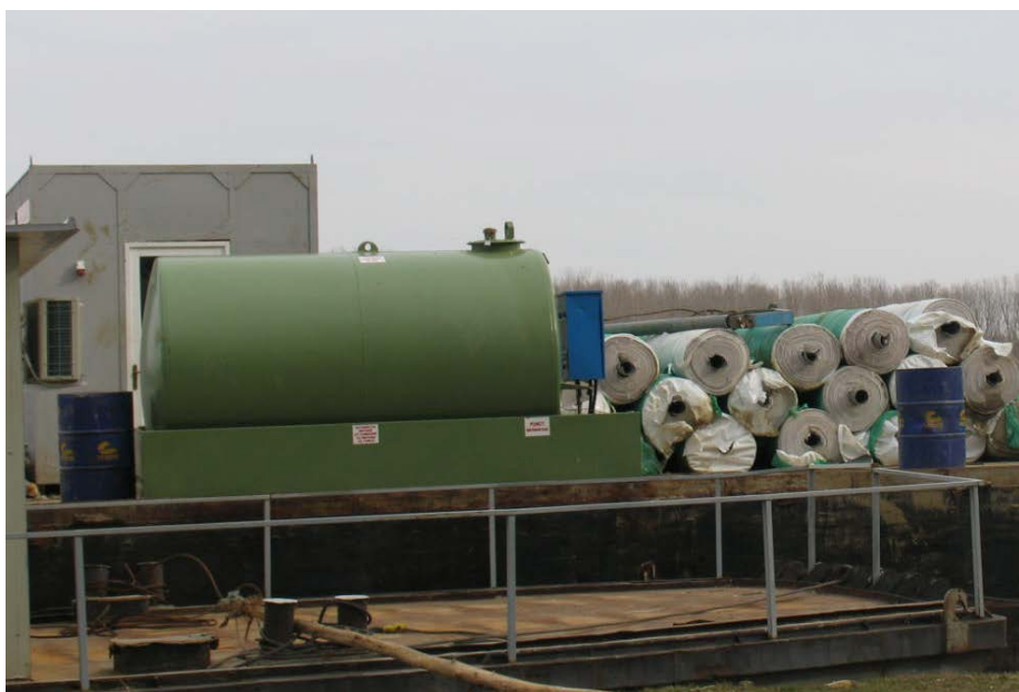
Foto 2 Rezervor metallic stocare carburanți amplasat în cuvă metalică și depozit saltele de geotextil
